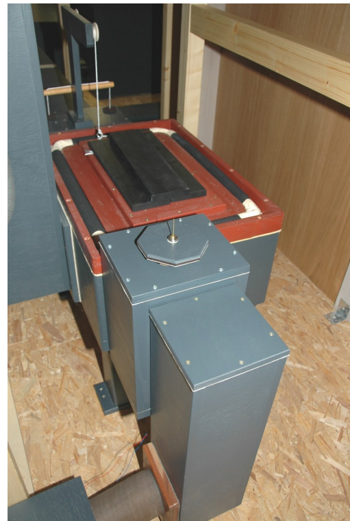
Unter den Windladen ist die Windversorgung montiert. Hier ein Regulier- balg zur Versorgung der Pedalpfeifen. Auf der beweglichen Balgplatte lie- gen Eisenbarren zur Erzeugung des nötigen Winddruckes.
